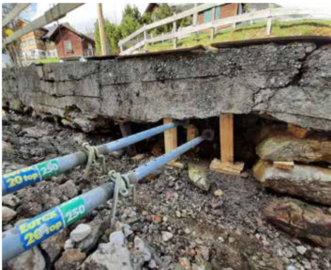
Die Beschädigungen an der Bachmauer des Thörlbaches waren weit fortgeschritten.
